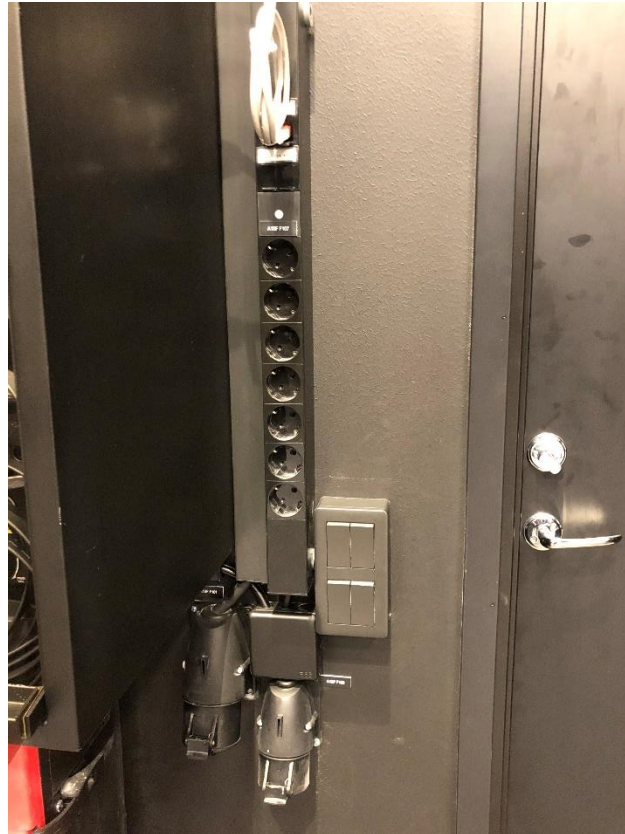
Vägguttag vänster om scen (sett från scenen) samt styrning av (dimbart) allmänljus
