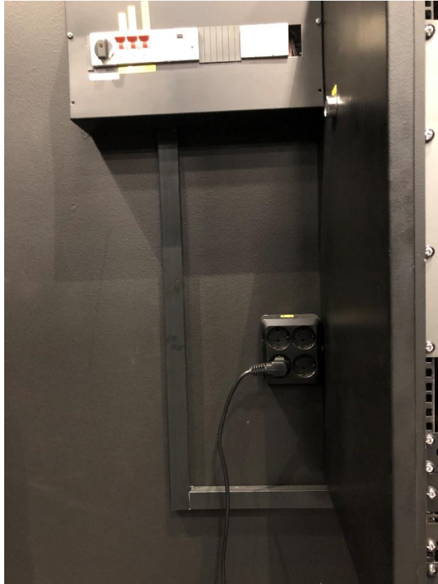
Vägguttag på vänster sida scenen, kopplade till av/på på teknikskåp
