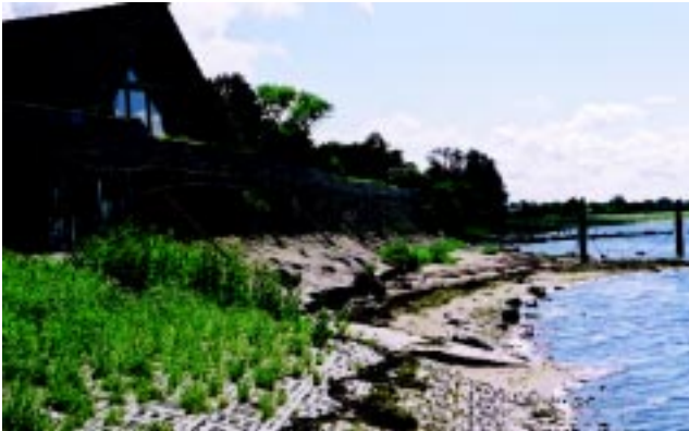
Fig. 17. Exempel på privat erosionsskydd som är i behov av upprustning..
